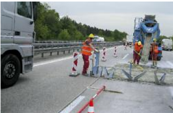
Abb. 1: Unzulässige Gefährdung der Beschäftigten durch fehlenden Sicherheitsabstand zum vorbeifließenden Verkehr (Quelle: BG BAU)
