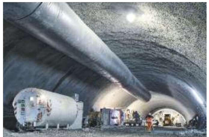
Abb. 7: Belüftung einer Tunnelbaustelle
